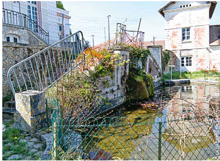
L'escalier et le bassin du château du Vivier devraient retrouver leur aspect d'origine d'ici trois à quatre mois.
