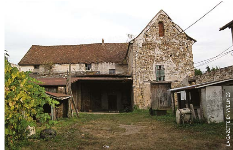
Des « travaux de sauvetage » seront effectués sur les bâtiments délabrés de la Maladrerie.
