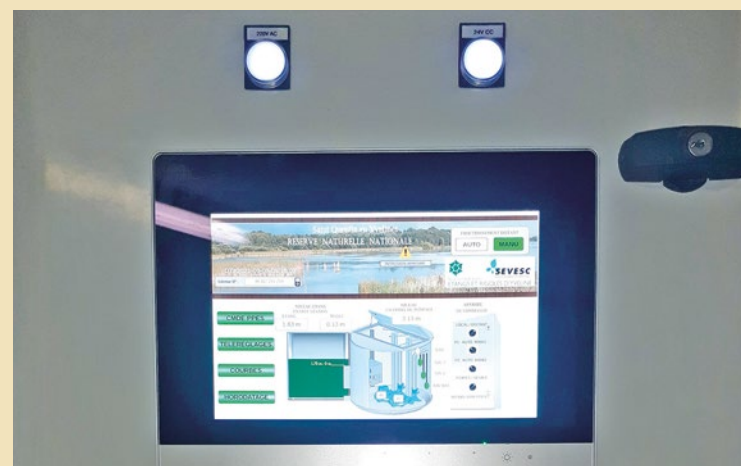
Cette année, la SEVESC, filiale du groupe SUEZ, a installé un système d'automatisme pour contrôler et piloter à distance les 2 pompes par l'intermédiaire d'un smartphone ou d'une tablette.
