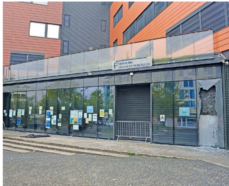
Les locaux du centre des finances publiques à Mantes-la-Jolie a également été la cible de casseurs durant ces nuits de violences.
