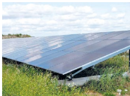
La centrale solaire de Triel-sur-Seine s'étend sur près de 19 hectares.
