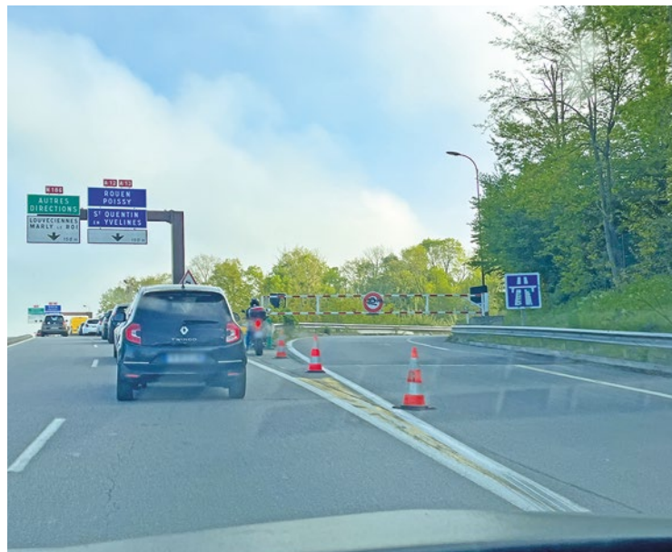
Depuis le 19 avril, une partie de l'autoroute A13 – entre Vaucresson (92) et le pont de Saint-Cloud – est fermée dans les deux sens à cause d'avaries structurelles.
