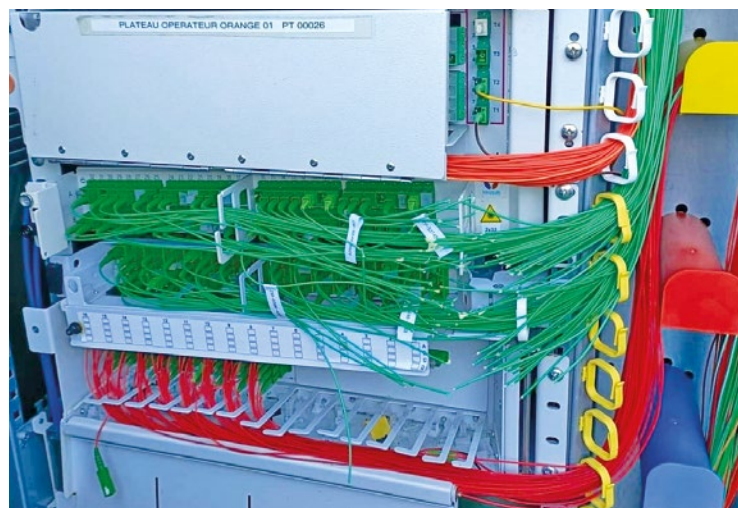
96 foyers seraient touchés par des pannes d'internet résultant de ces actes de vandalisme, selon Bouygues.
