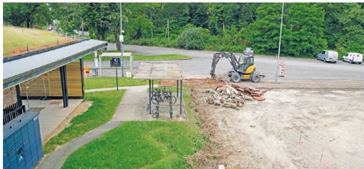
Ces travaux vont permettre à la gare vernolienne d'assumer une fréquentation qui augmentera de 25 % avec l'arrivée du RER E.
