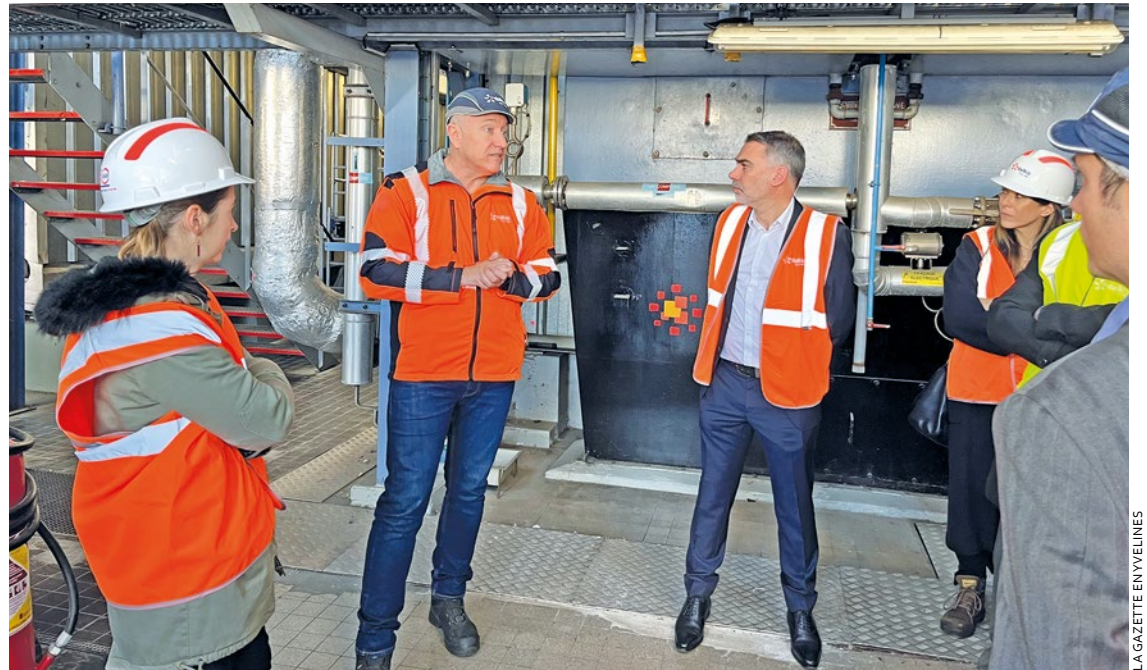
La chaufferie Dalkia de Mantes-la-Jolie existe depuis 1965.
