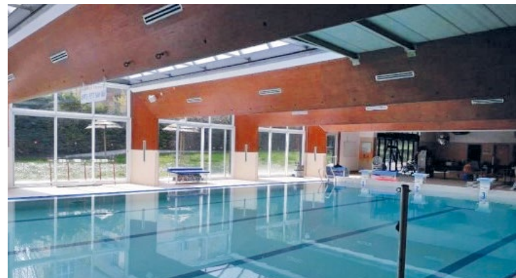
L'incendie s'est déclaré lors des travaux d'étanchéité.
